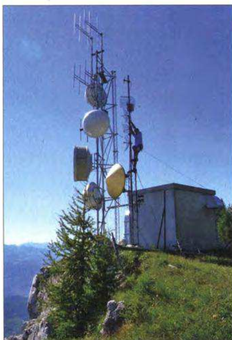
Bild 6: Sendeanlagen am Gantkofel (1866 m) bei Bozen; neben dem Rittner Horn (2260 m) ist dies ein zentraler Knotenpunkt für HAMNET und Allstar-Link in Südtirol.
